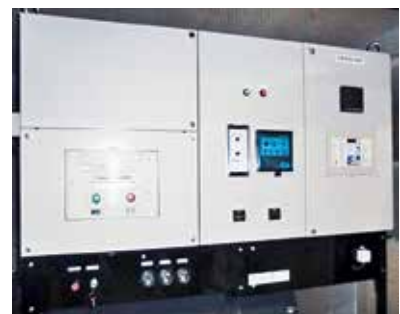
高圧搭載形発電機自動始動盤
